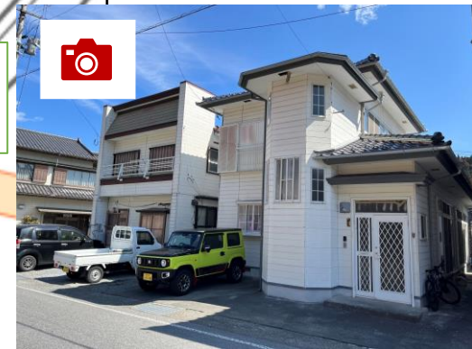
輻射熱による被害
